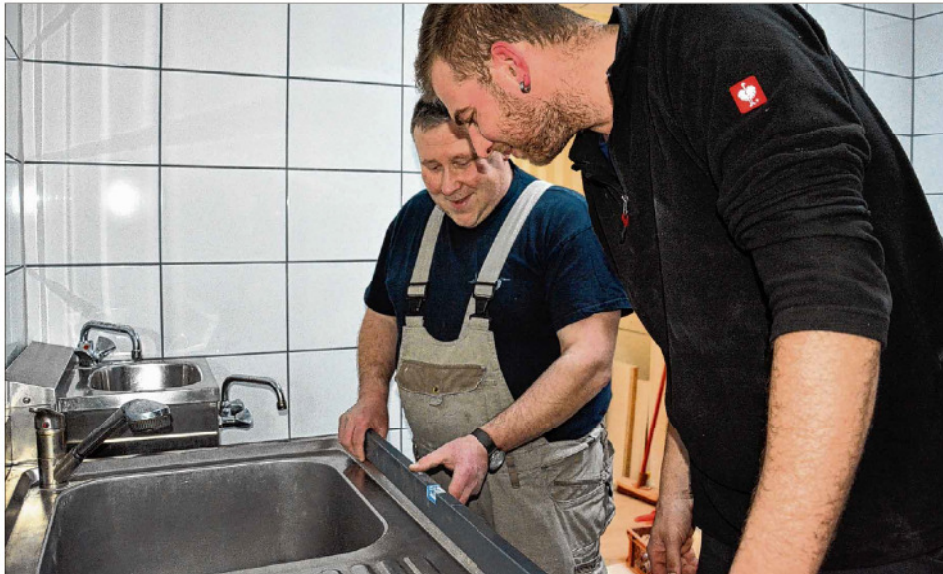
Matthias und Dirk Schmidt kontrollieren, ob die Spüle in Waage steht. Schließlich soll in der Küche des kleinen Cafés „Zum Schleich“ alles passen, wenn am Sonntag eröffnet wird. Fotos (3): Sabine Scholz
